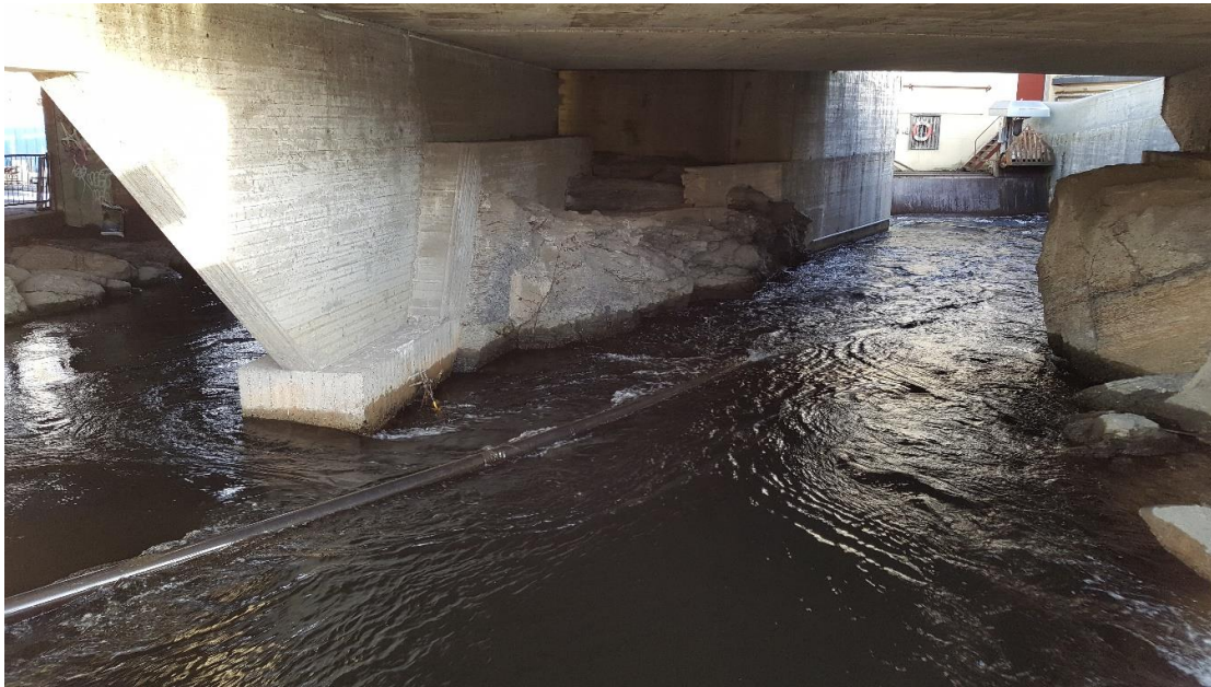
Figur 11: Inntakskanal mot turbininntaket til Eidet kraftverk. Foto: M. Kraabøl.
