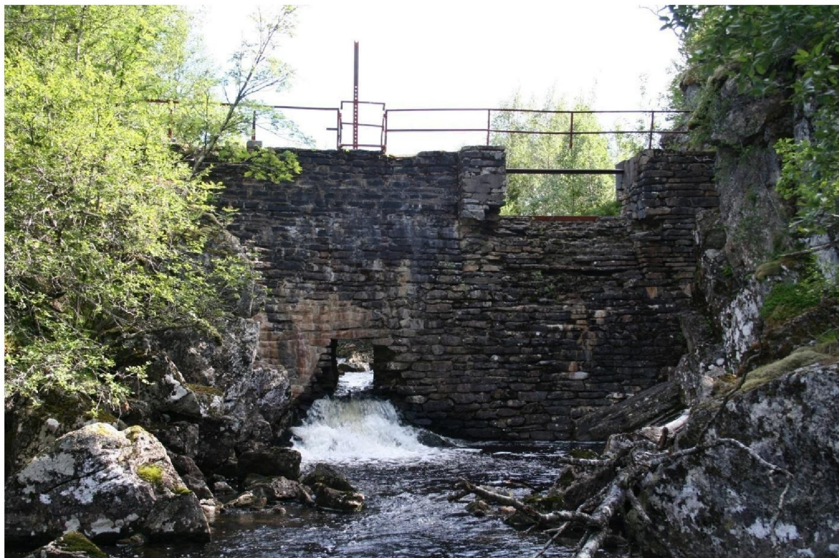
BILDE 7: DAMMEN SETT FRA NEDSTRØMS SIDE. HER SER EN TYDELIG DET GAMLE FLOMLØPET OG DEN ÅPNE BUNNLUKEN SOM FUNGERER SOM AVLØP. DAMMEN VIL BLI REVET OG NY BETONGDAM BLIR BYGD PÅ SAMME STED.
