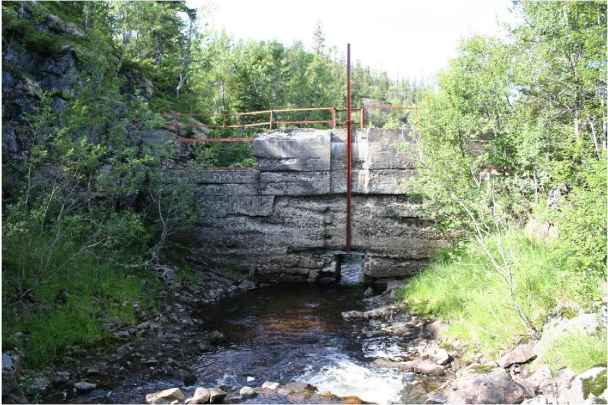
BILDE 6: DEN GAMLE MURDAMMEN SETT FRA OPPSTRØMS SIDE. SOM EN SER SÅ ER DET I DAG KUN EN LITEN LUKE I BUNN SOM FUNGERER SOM AVLØP. DET ER TYDELIGE MERKER PÅ DAMMEN ETTER TIDLIGERE REGULERINGER, DE GÅR HELT OPP TIL FLOMLØPET. FLOMLØPET ER TIL VENSTRE I BILDET OG CA 2 M BREDT. VANNFØRINGEN PÅ BILDET ER BEREGNET TIL 0,12 m 3 /s.
