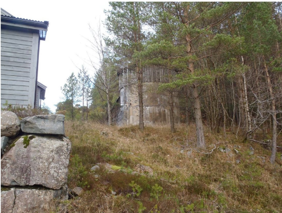
Røyrgatetrasè til høgre for sirkulært trykkreduksjonsbasseng, som ikkje er i drift lenger.
