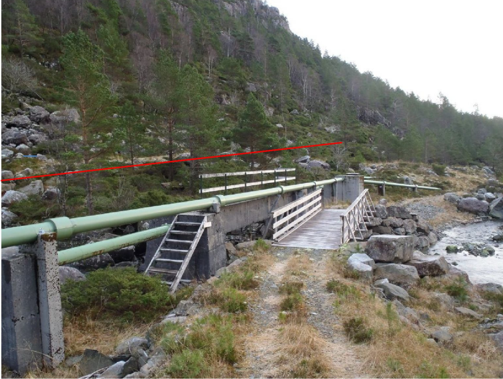
Vassleidningane kryssar elva. Røyrgatetrasè vil ligge i skråninga til venstre for desse.
