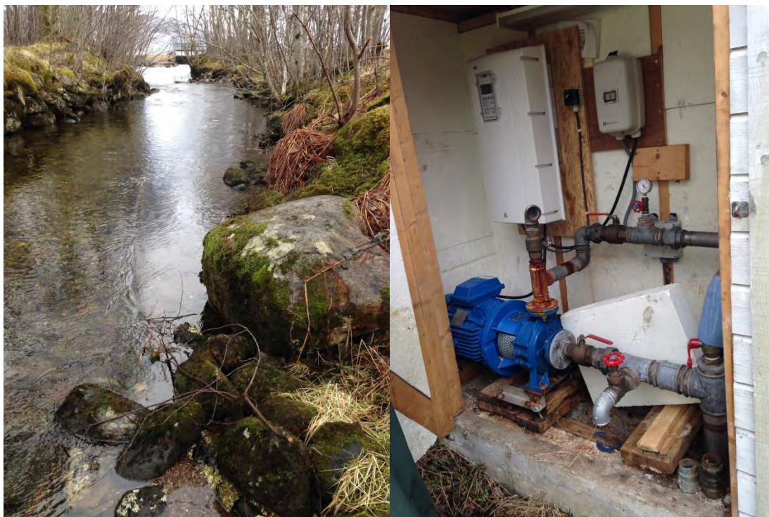
Figur 1 Eks. inntaksledning og pumpestasjon.
