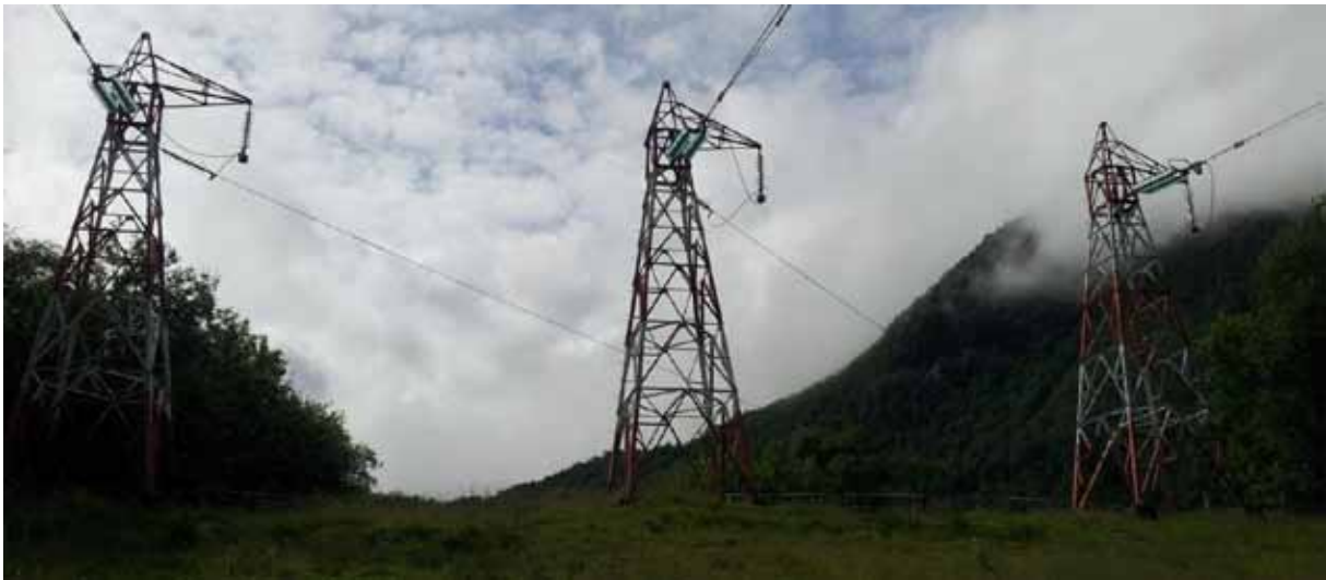
Figur 2.4. Eksempel på 132 kV fordspennmaster.
