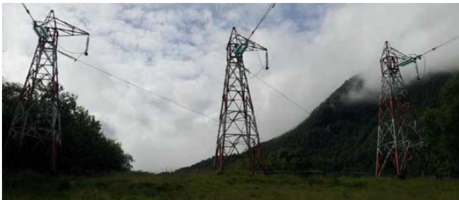
Figur 4: 132 kV fjordspennmast som er planlagt over Austgulfjorden.
