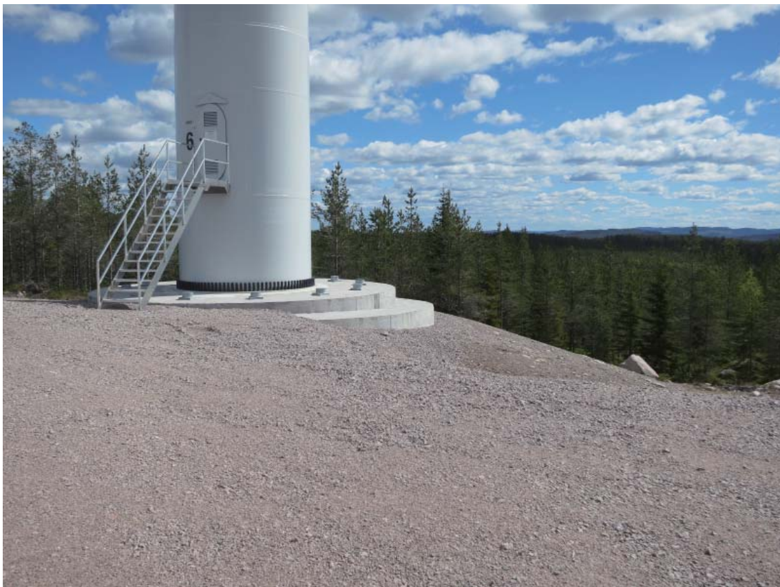
Et virkemiddel for å gi fundamentet bedre visuell forankring kan være å støpe på trinn for å ta opp høydespranget
