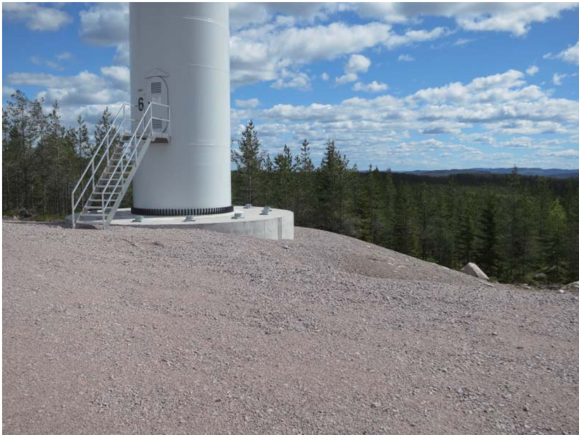
Fundament som ikke flukter med oppstillingsplassen ser rotete og ustødig ut
