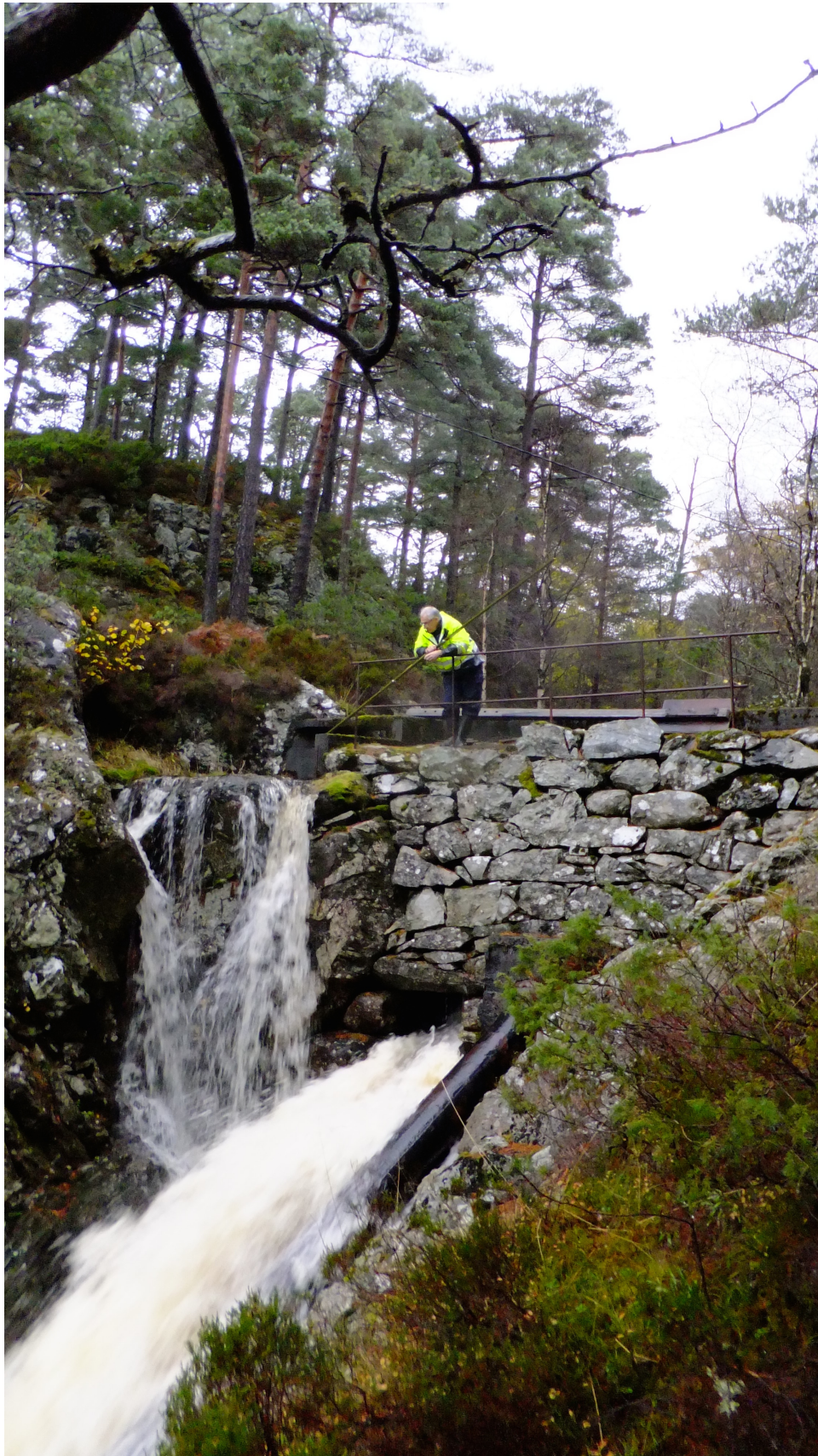
Bilde 2. Inntaksdam overløp, bunntappeluken og rørkonus Bildet er tatt 24. okt. 2014 med åpen bunntappeluken i flomsituasjon.
