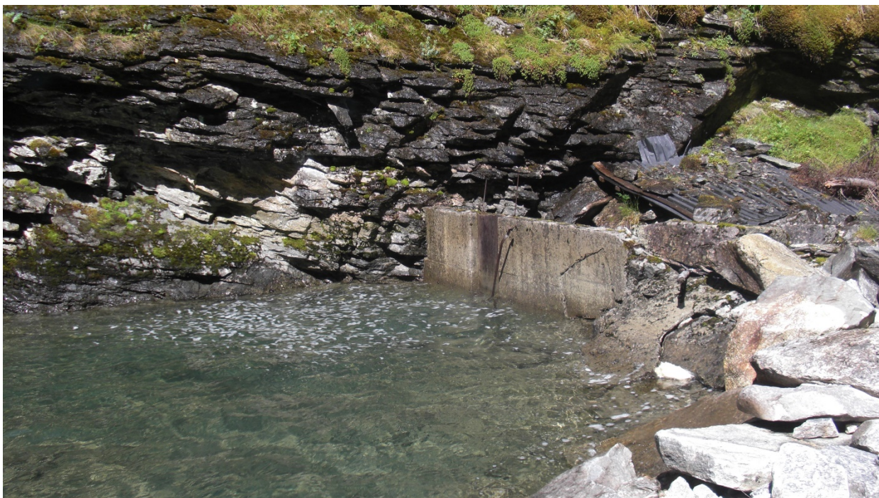
Fig. 1.2. 1 Bildet syner inntaket til vassverket ved lav vassføring slik det er i dag. Bildet er teke mot vestsida.
