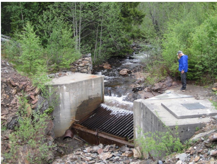
Bekkeinntak Hegset kraftverk like nedstrøms stasjon
