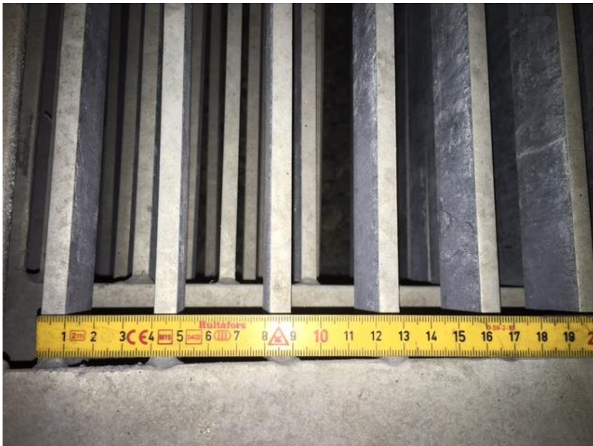
Bilde 3. Nærbilde av sperregitter som er tilpasset kraftverksutløpet i Kåfjordelva. Det er om lag 30 mm lysåpning mellom spaltene i sperregitteret. Foto: Ronald Hardersen, Troms Kraft.
