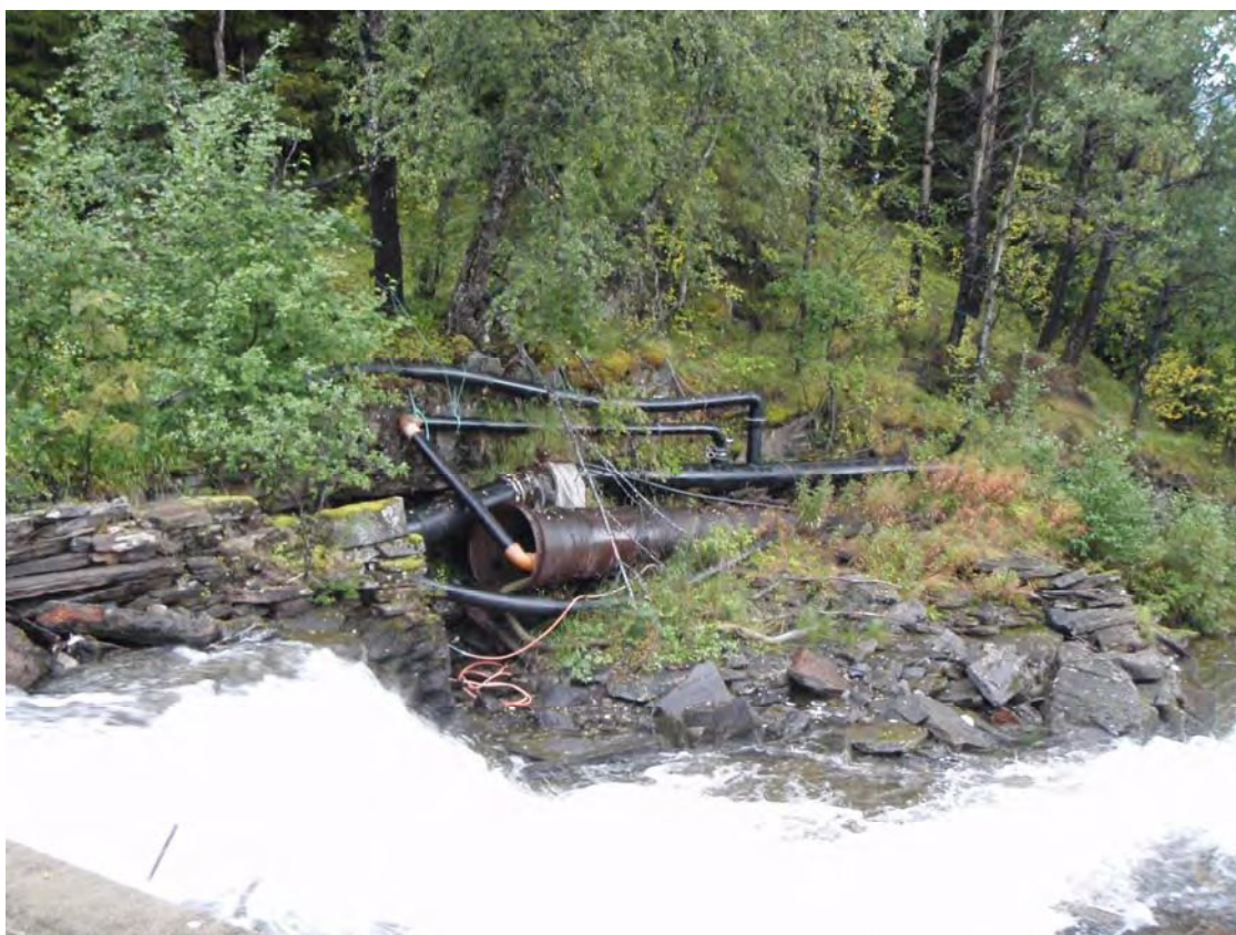
Rør i Foldvikelva i forbindelse med vannforsyning til Astafjord smolt.
