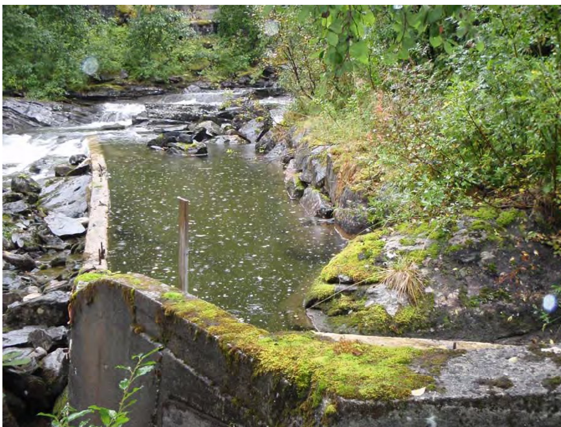
Inntak Ytre Foldvik vannverk
