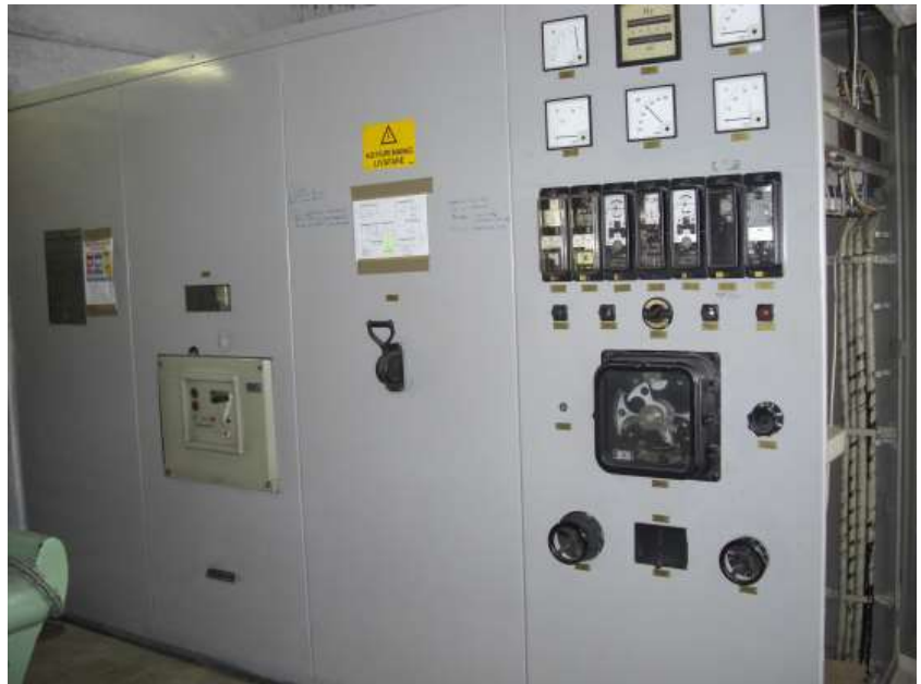
Bilde 5: Inne i eksisterende kraftstasjonsbygg. Foto: Rolf Amundsen.
