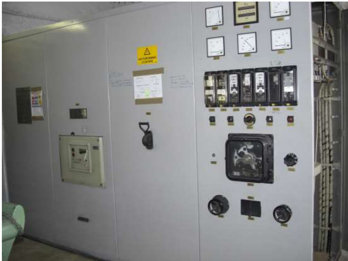
Bilde 10: Kontrollanlegget i gammel kraftstasjonen. Foto: Rolf Amundsen
