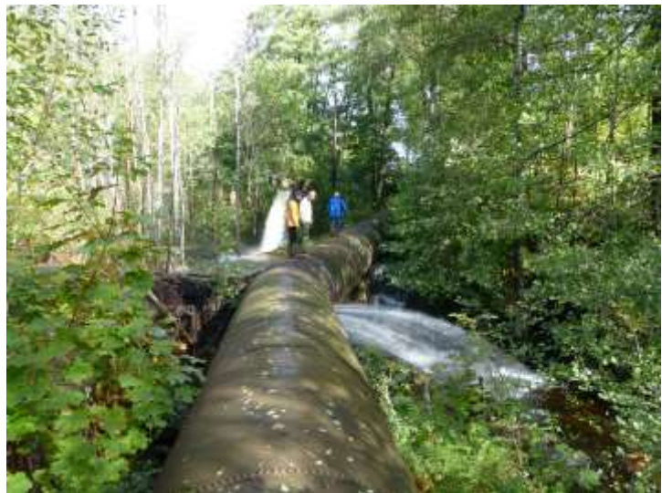
Bilde 4: Bildet viser dagens rørgate. Foto: Rolf S Amundsen.
