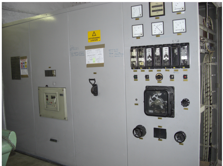
Bilde 6: Inne i eksisterende kraftstasjonsbygg. Foto: Rolf Amundsen.
