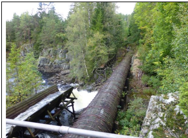
Rørgate like nedstrøms dammen. Foto: Rolf Amundsen
