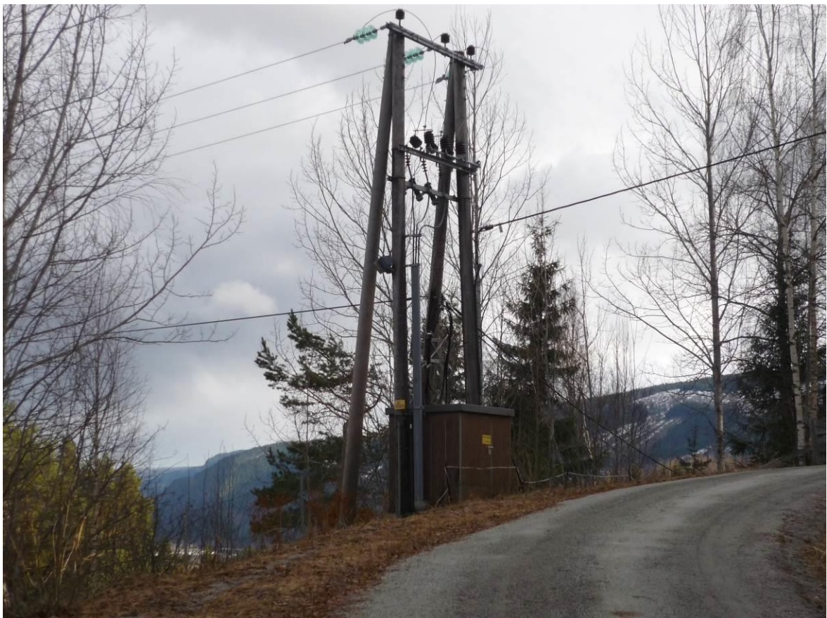
Bilde 6.1 Eksisterende 22 kV nettstasjon
