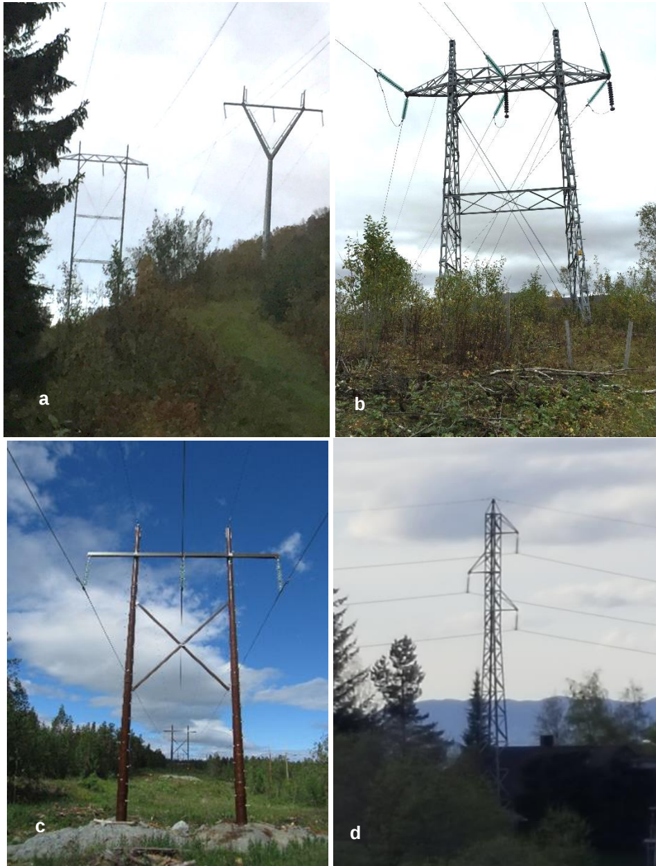
Bilde 2. a) Rasmast ved Bogen til høyre, selvbærende standard portalmast venstre. Begge er 132 kV. b) En typisk forankringsmast, 132 kV. c) 132 kV komposittmast med ståltravers. d) Enkeltfas mast med trekantoppheng (denne er 66 kV). Foto: Statnett.
