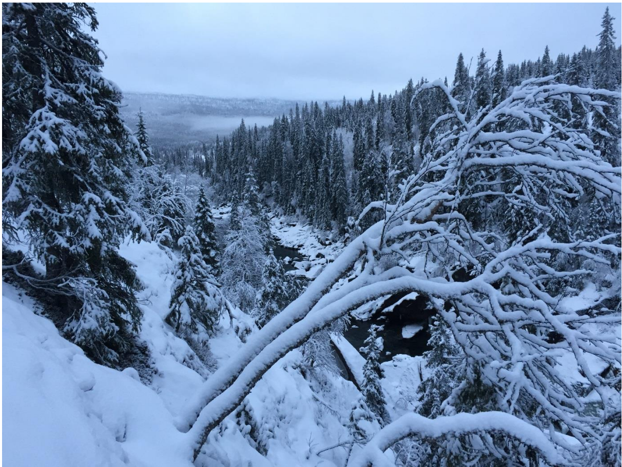
Kryssing Ranelva i luftspenn.
