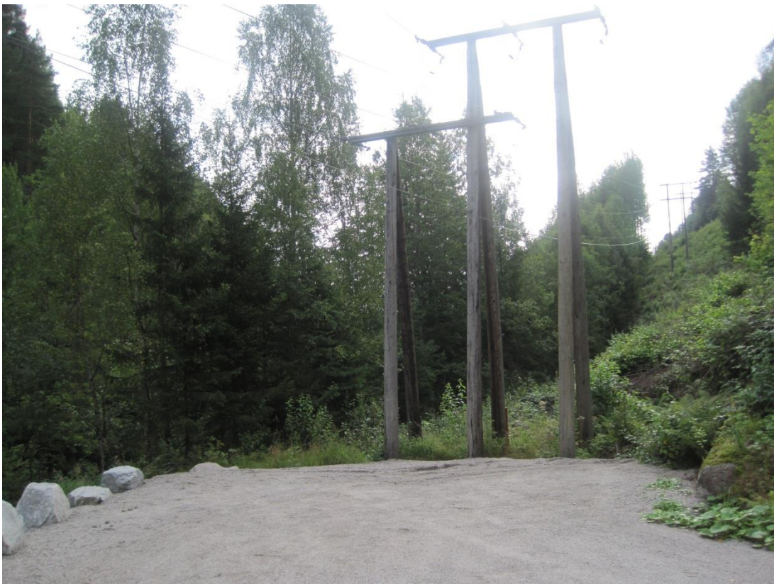
“bildet viser rett nedenfor Suvdøla kraftstasjon som viser utgående 22KV høyspent-linjer fra eksisterende kraftstasjon”
