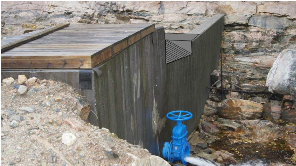
Fig 7. Eksisterende bekkeinntak i Storlibekken. Nedbørfelt cirka 1,7 km 2 . Tegnet med skrårist for selvrensing.
