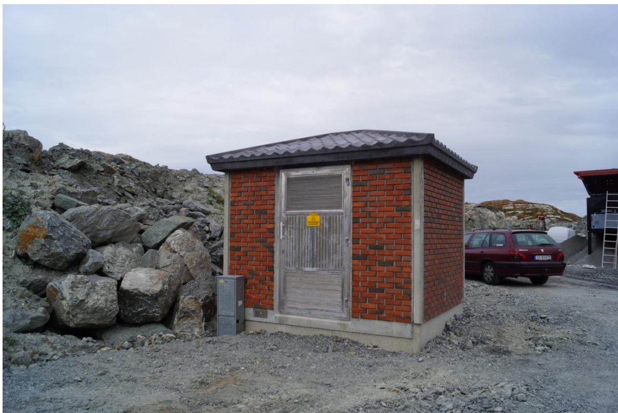
Figur 3: Eksisterende nettstasjon, vindparkens tilknytningspunkt (TP)
