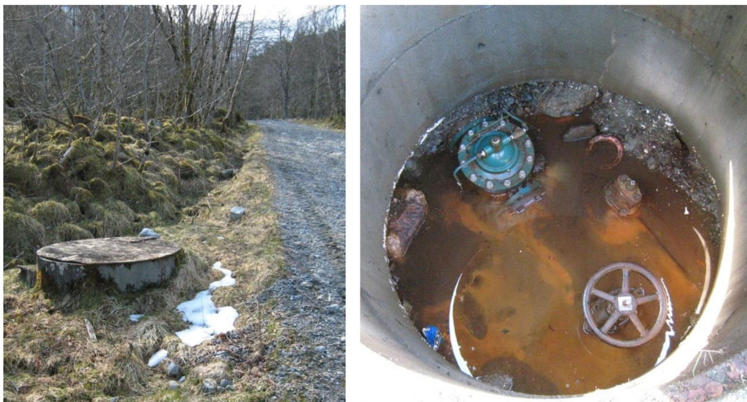
Figur 6 Kum til vannverket på kote ca. 75.
