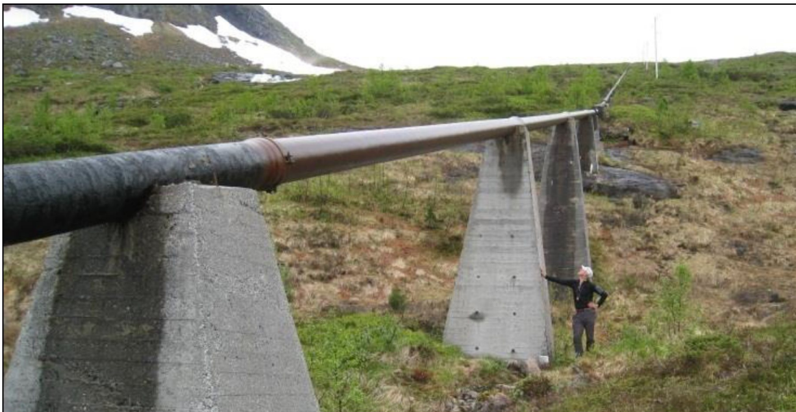
Figur 4 Eksisterende trykkrør er fundamentert på høye betongfundamenter omtrent ved kote 350. Langs resten av rørstrekningen er det lave betongfundamenter. Det vil bli vurdert gjenbruk av de fleste fundamentene.
