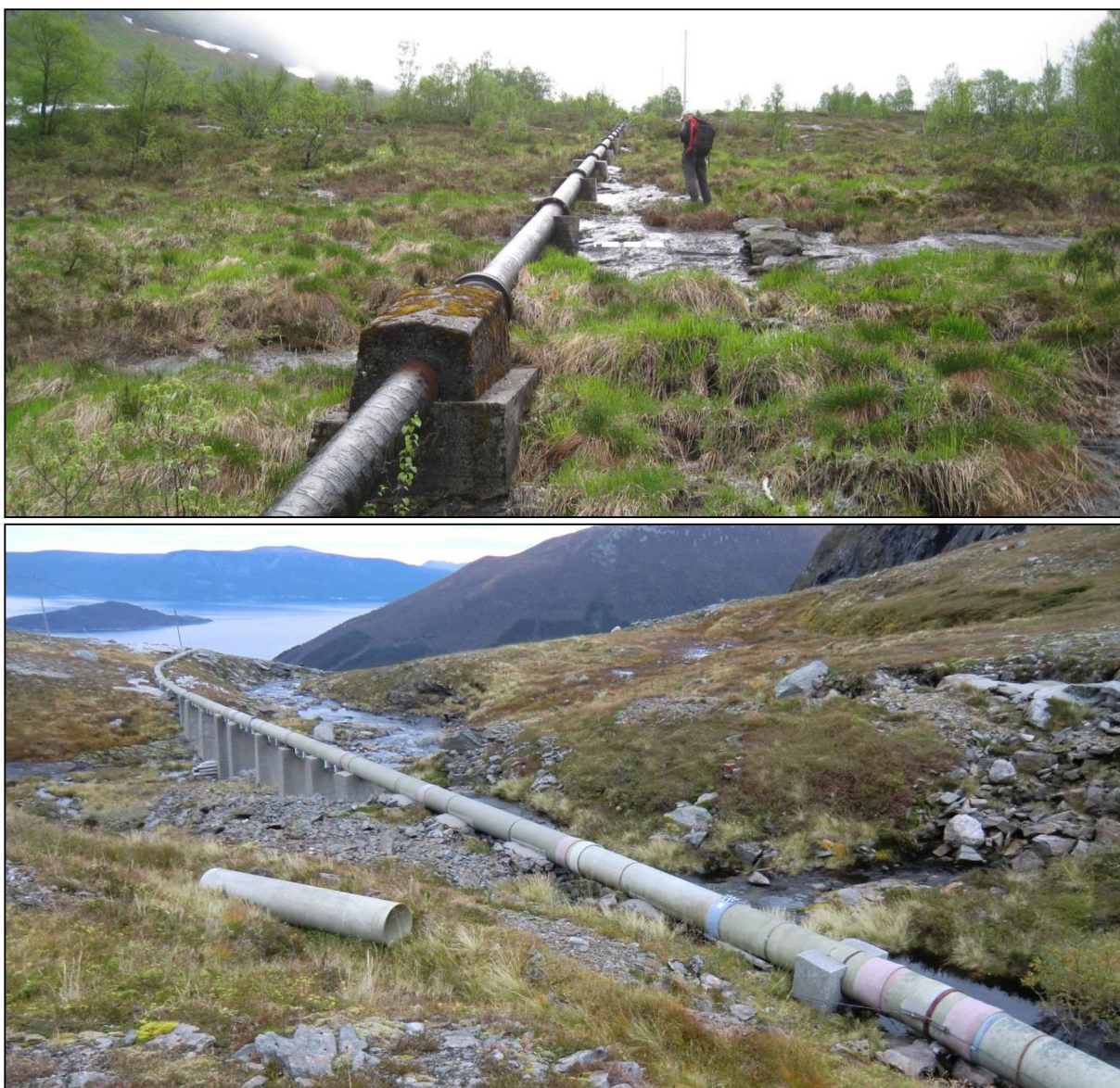
Figur 13 Øvre bilde viser eksisterende trykkør noe ovenfor kraftstasjonen. Nederste bilde viser eksisterende trykkør like nedstrøms inntaksdammen. Nytt trykkør legges på fundamenter i samme trasé som eksisterende trykkør.
