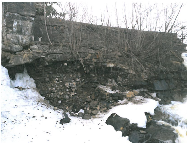
Figur 3 . Løkkadammen, erodert damhel ved bunnløp
