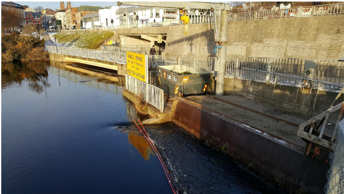
Figur 10: Turbininntakene til Eidet-kraftverkene. Foto: M. Kraabøl.
