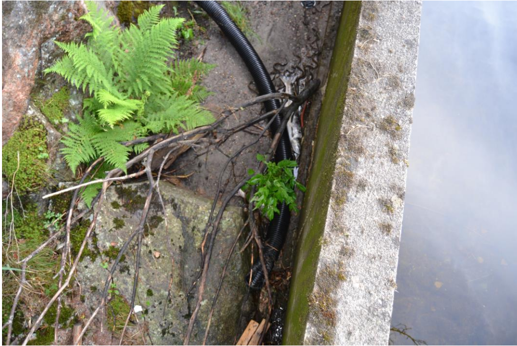
Figur 5. Åleyngel på oppvandring ved siden av fisketrappa ved Skotfoss. Åleyngelen ses på oversiden av det svarte plastrøret. En død smålaks har hoppet ut av fisketrappa og ligger der hvor åleyngelen kryper på betongdekket (Foto: Dag Natedal).
