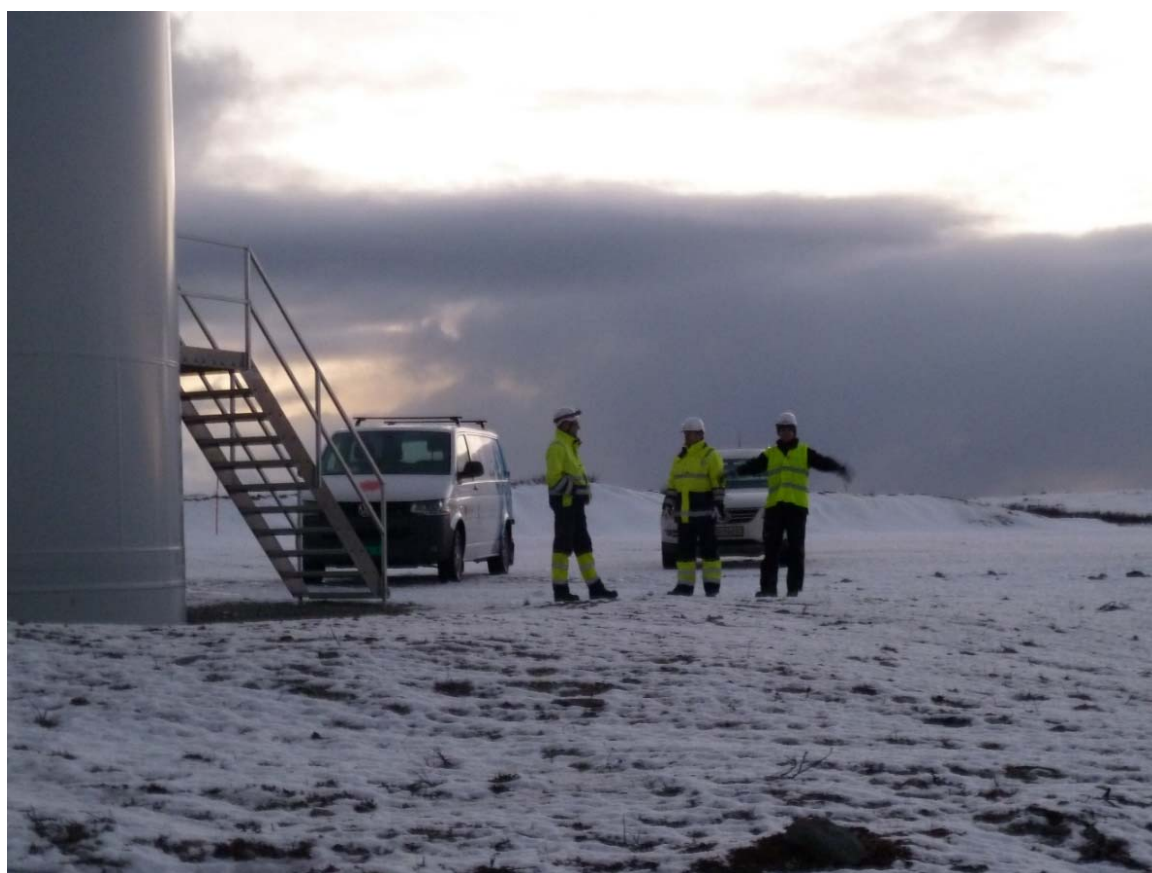
Figur 19: Bilde fra Fakken vindkraftverk. Ryddig fundament og kranoppstillingsplass i samme nivå. Foto Ulf R. Hanssen.
