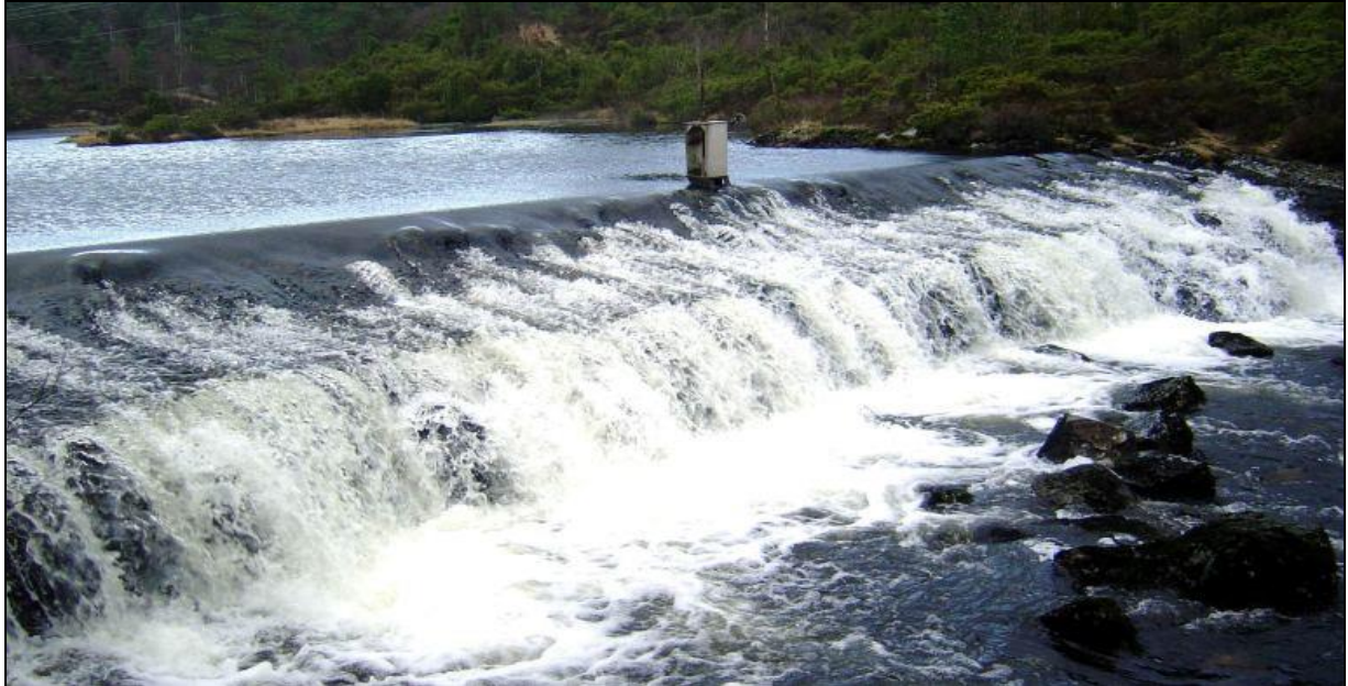
Figur 2. Den gamle stemmen i utløpet av Onarheimsvatnet, der innsjøen kan senkes med inntil 1,5 meter.
