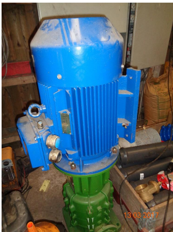
En Rovatti MEKV80_60 pumpe blir installert
