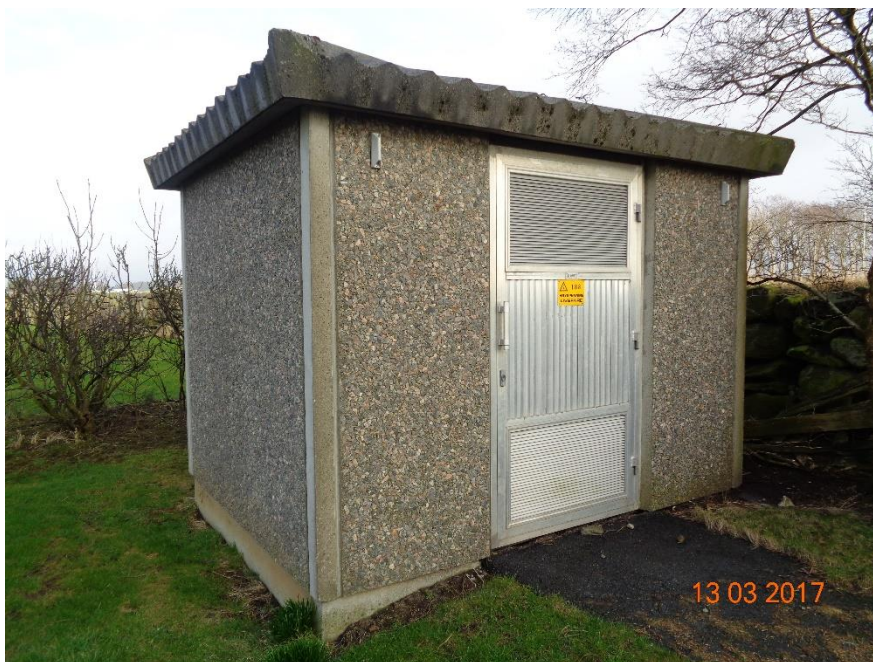
Selve pumpehuset blir av denne typen
