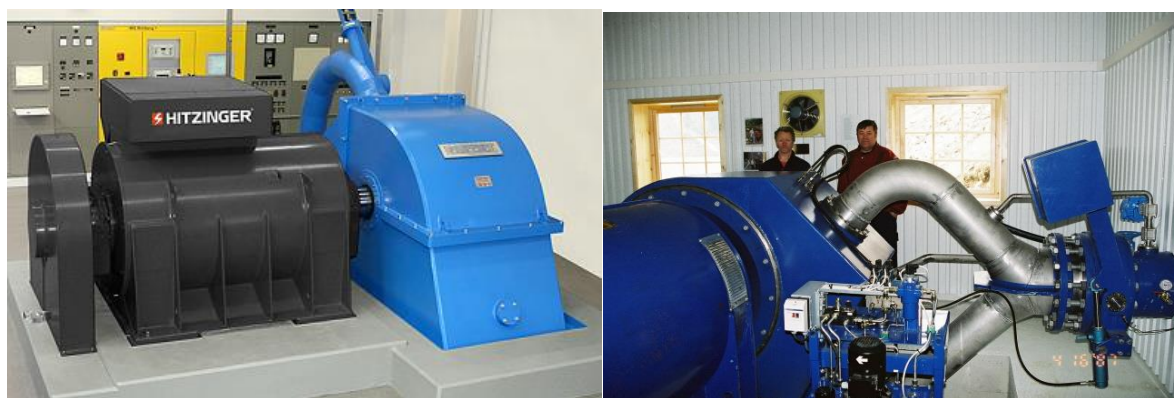
Figur 58 og 59: Innvendig vil kraftsasjonen få 2-stråla pelton med horisontal aksling. Norskproduert turbin til høgre.
