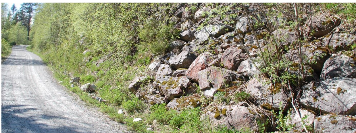
Figur 47: Nedgraving av røyrkata i dette partiet kan gje risiko for ras av ustabile massar. Mur frå 1980-åra etter skred.
