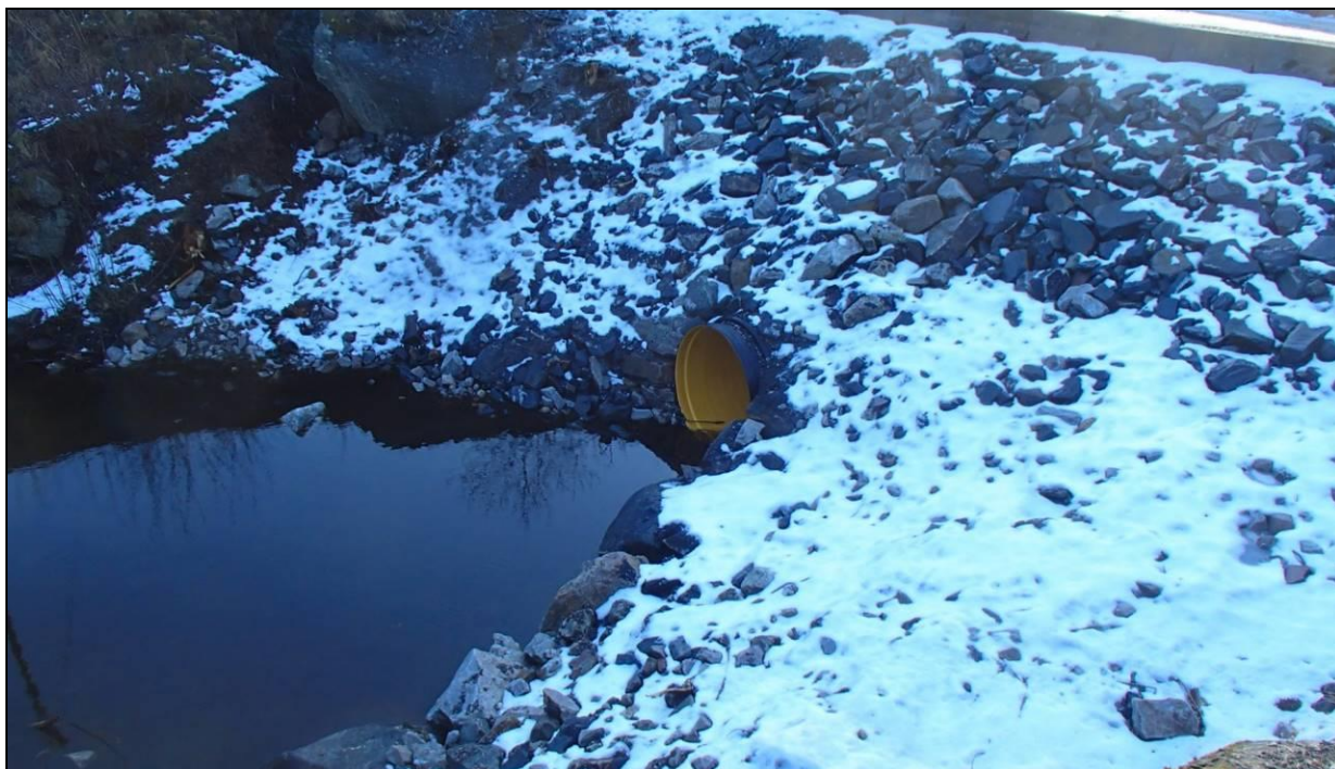
Figur 13. Den 250 m lange utløpselven fra Lona krysser under to veier på en bratte strekningen end til sjøen. Her er nederste veikryssing etter at røret gjennom fylling nylig er skiftet.
