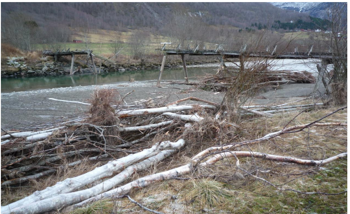
Foto 1. Den ødelagte Flohaugsbrui og trær langs elvebredden av Mørkriselva var tydelige spor etter storflommen tidlig i oktober høsten 2010. Foto 12.11.2010.
