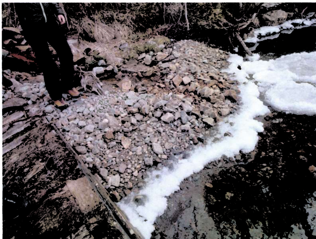
Ras/løsmasser inn i kulpen
