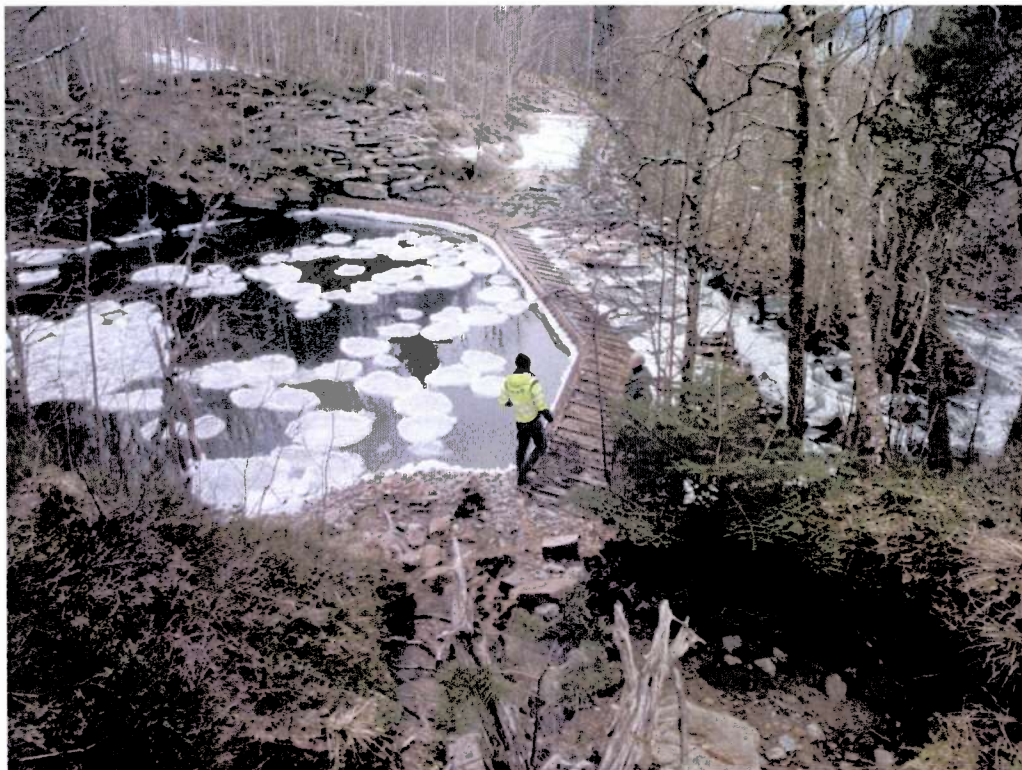
Herjeelva. Inntaksdam 185 moh. gammelt kraftverk. Store lekkasjer gjennom dammen
