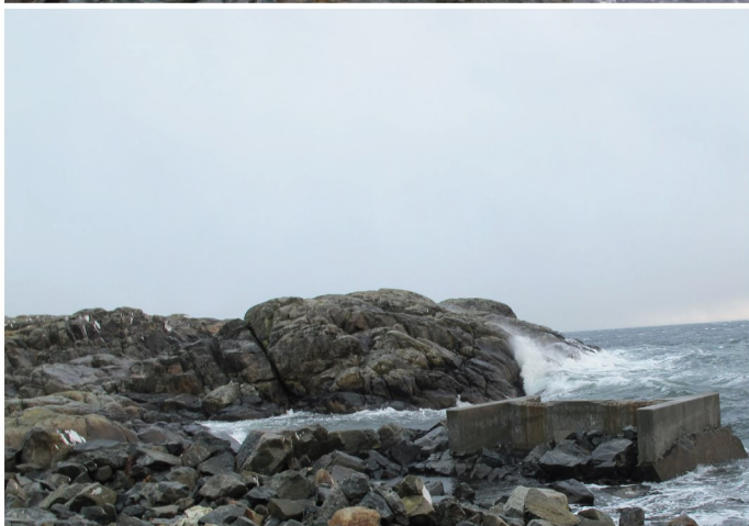
Figur 6: Anleggskai som ble laget i forbindelse med eksisterende vindkraftverk kan brukes, men må restaureres og kvalitetsikres.
