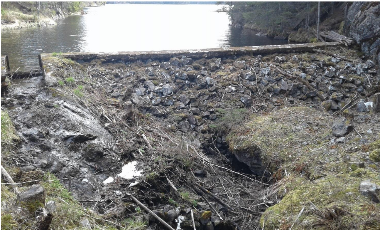
Foto 5. Hoveddam har lekkasjer (Kjærås, mai 2017).
