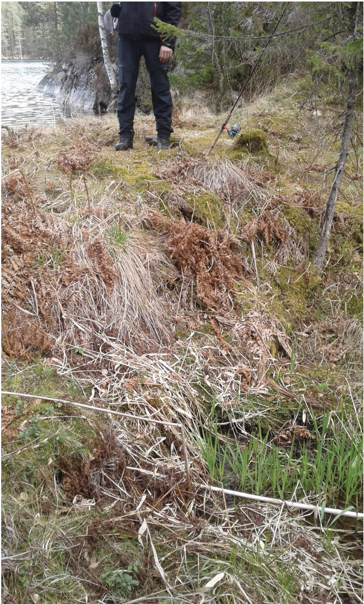
Foto 32. Nyoppdaget, ukjent dam. Har lekkasje (Kjærås, mai 2017).
