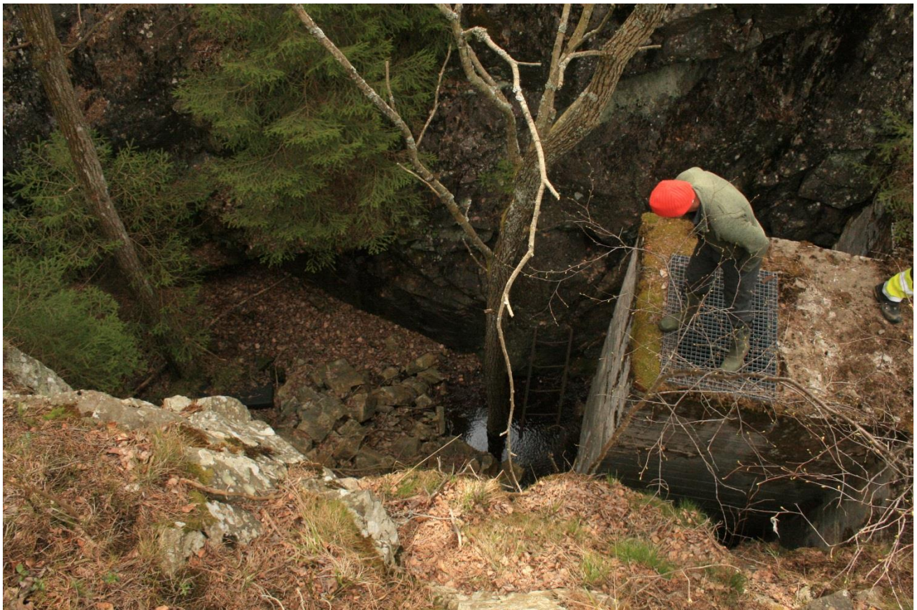
Foto 18. Mulig tørrlagt bekkedal. Sperredam. Stor lekkasje. Uten sikring. Mange meter ned i kløft (Erath, mai 2017).
