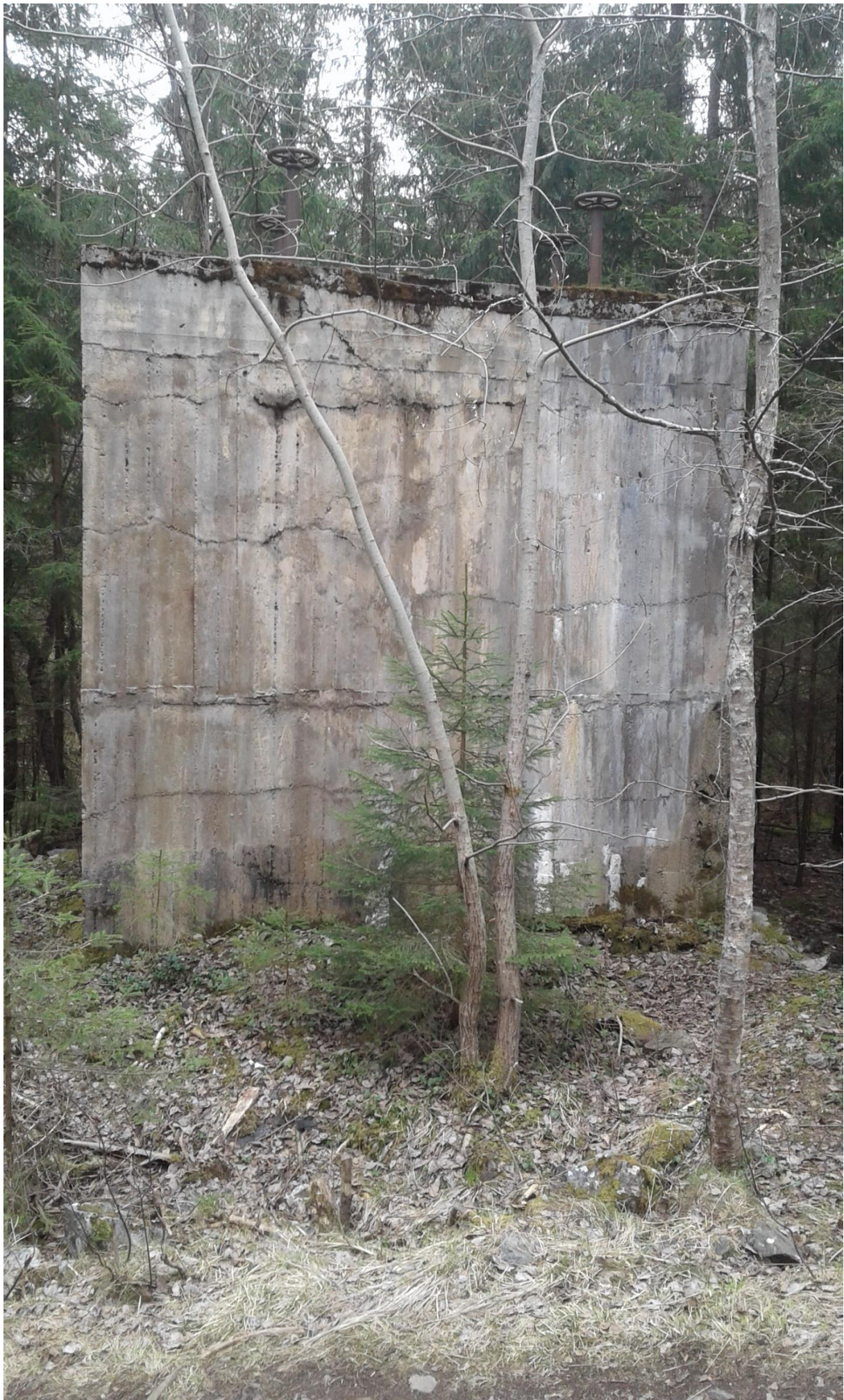
Foto 39. Ventilammer (Kjærås, mai 2017).
