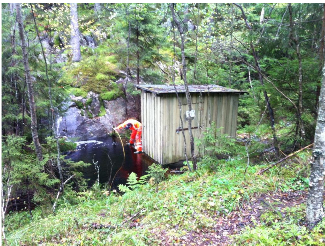
Figur 3-6. Situasjonen ved dammen i 2011 før senkning av vannstand og gjenstøping av kum (Vassbygg).
