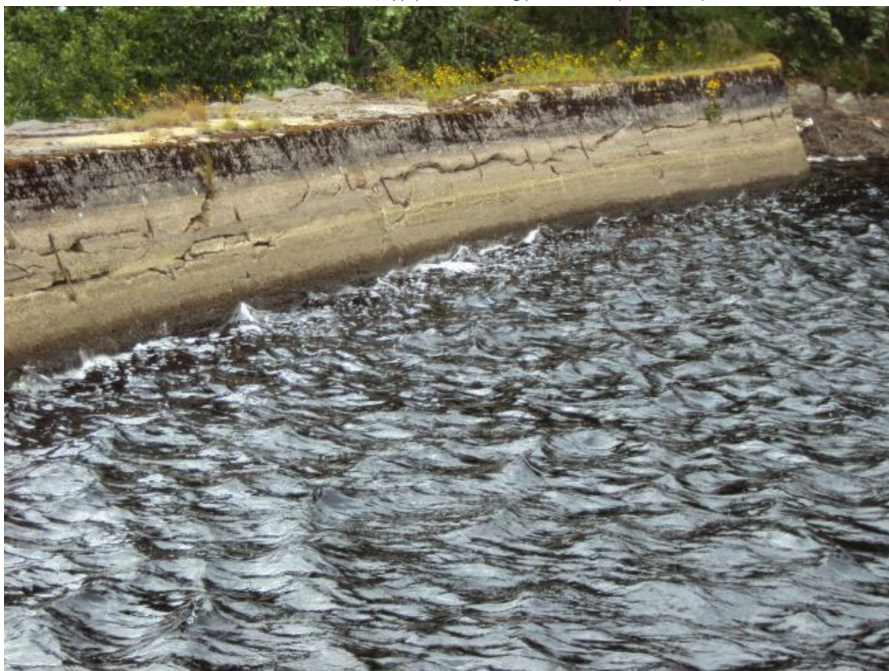
Foto 16 Område med skadet/oppsprukket betong på vannsiden (Sweco 2017).
