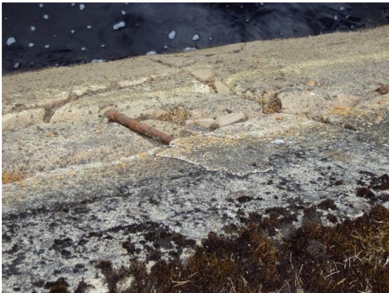
Foto 12 Betongen på vannsiden er «vasket» ut. Synlig armering og oppsprukket, se også foto 13. (Sweco 2017).
