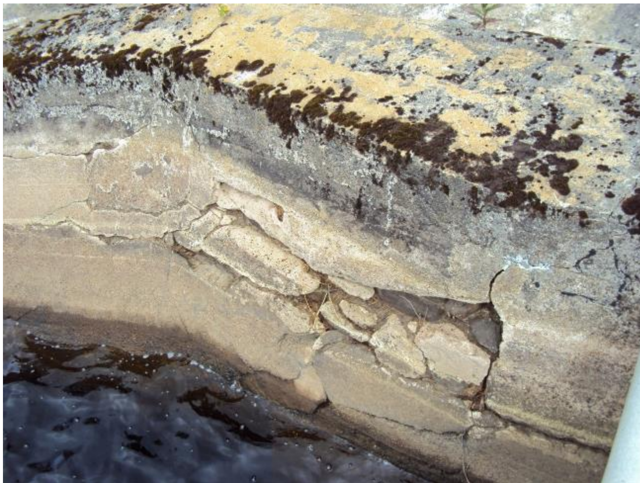
Foto 15 Område med skadet/oppsprukket betong på vannsiden (Sweco 2017).
