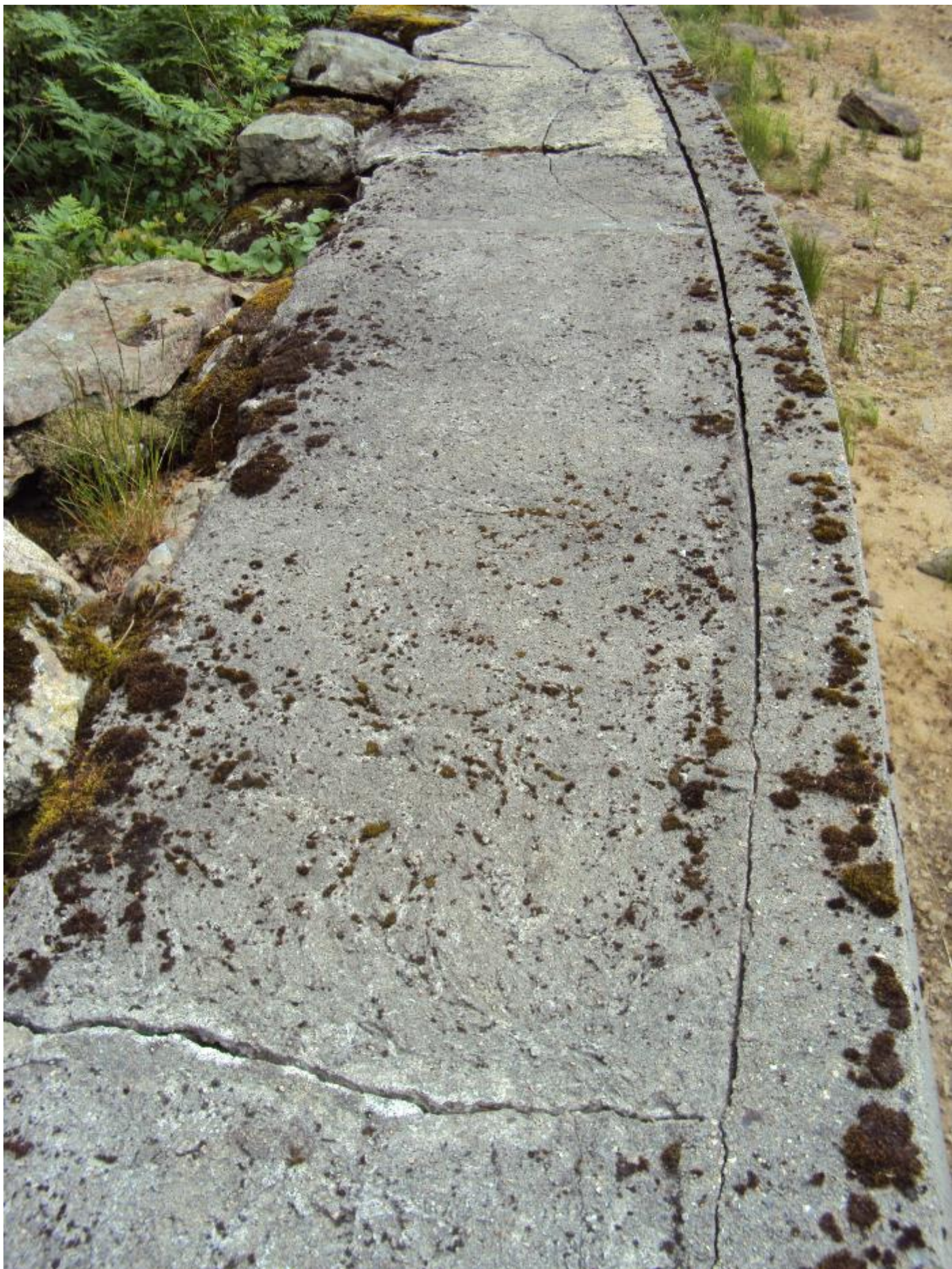
Foto 14 Topp dam Nord-Østre del. Oppsprekkinger. (Sweco 2017).
