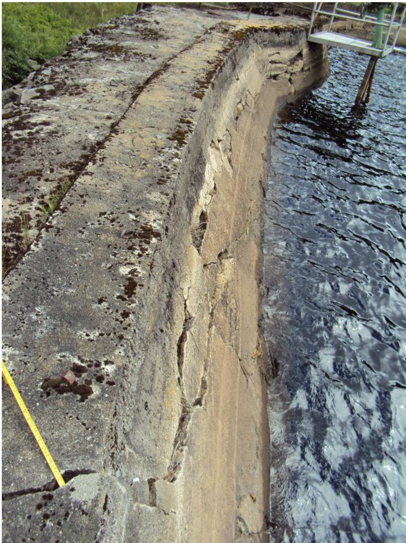
Foto 13 Deformasjon på topp dam. Stabil over de siste årene. For øvrig synlig oppsprukket betong på vannsiden (Sweco 2017).
