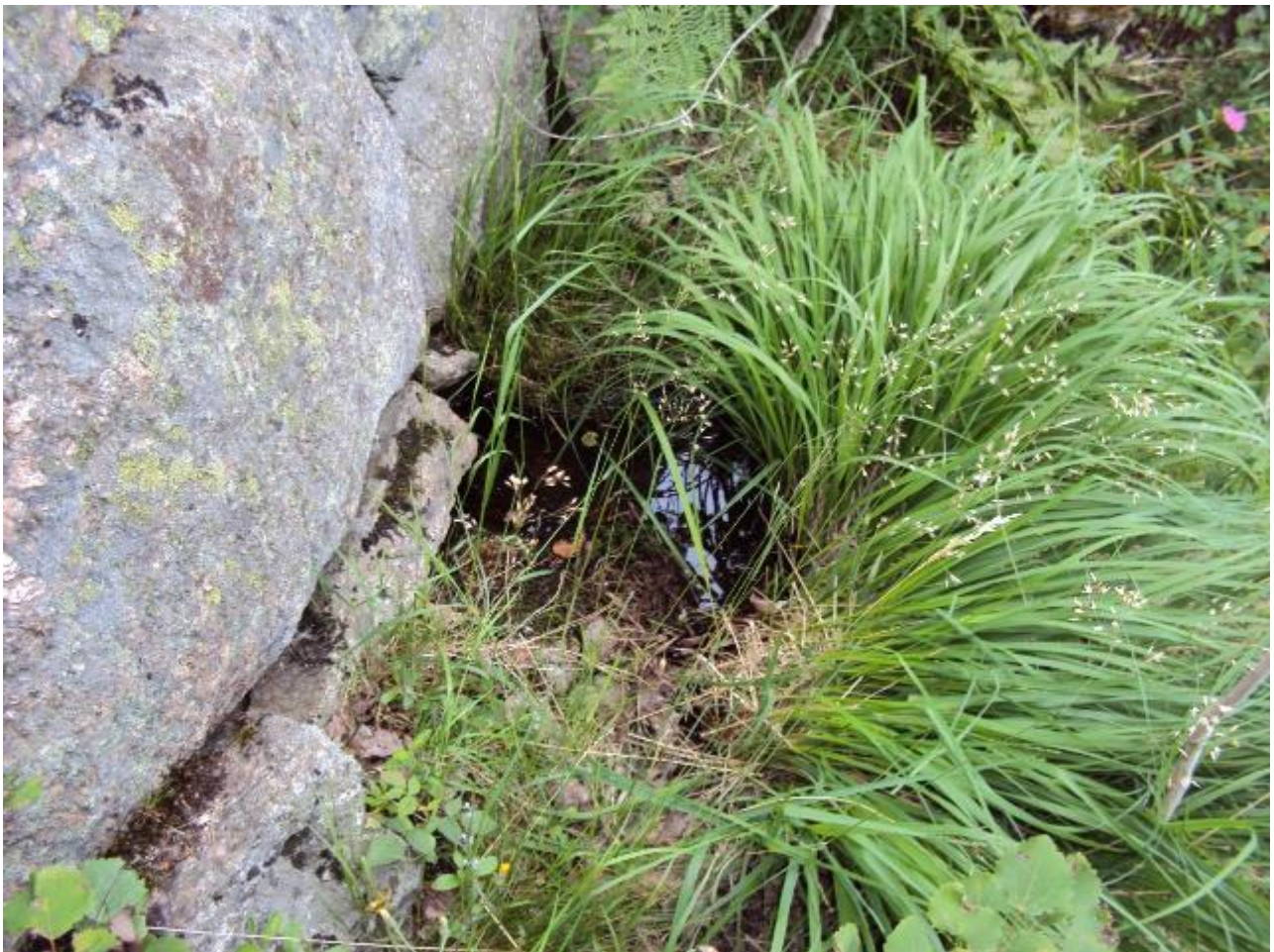
Foto 18 Noe lekkasje i bunn dam. (Sweco 2017).
