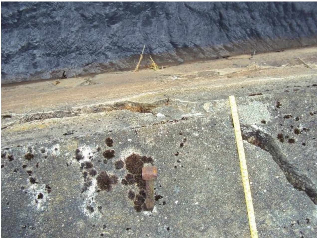
Foto 11 Deformasjon på topp dam. Stabil over de siste årene. (Sweco 2017).
