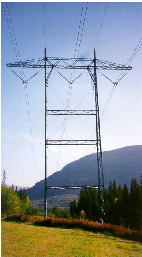
Figur 4: Statnetts standard bæremast. Nye, permanente bæremaster ved Liåsen vil se like ut.
