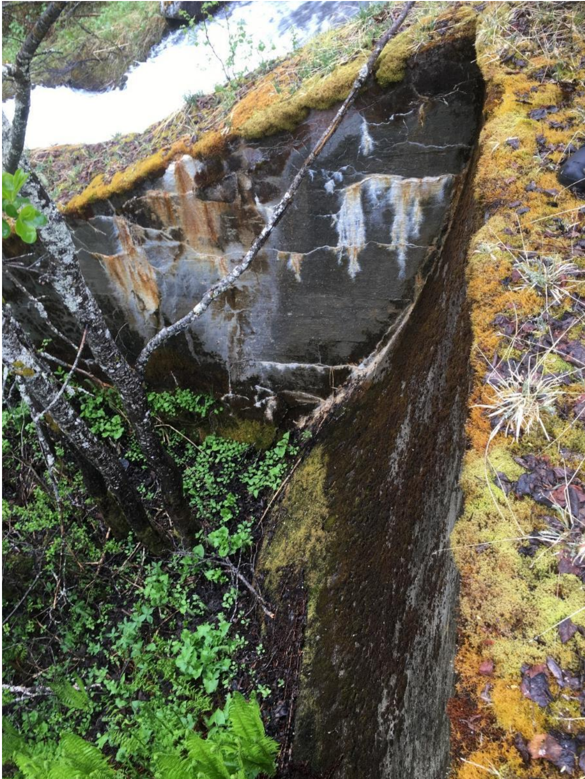
Figur 6 Demningens sydvestre og midtre del. På bildet kan man klart se at midtre del (som er den del av demningen som utsettes for størst vanntrykk) er vesentlig tykkere nederst (ved bregnene) enn øverst (til høyre i bildet). Tykkelsen nederst estimeres maksimalt 2,5-3,0 m. Tykkelsen øverst er 1,00 meter.
