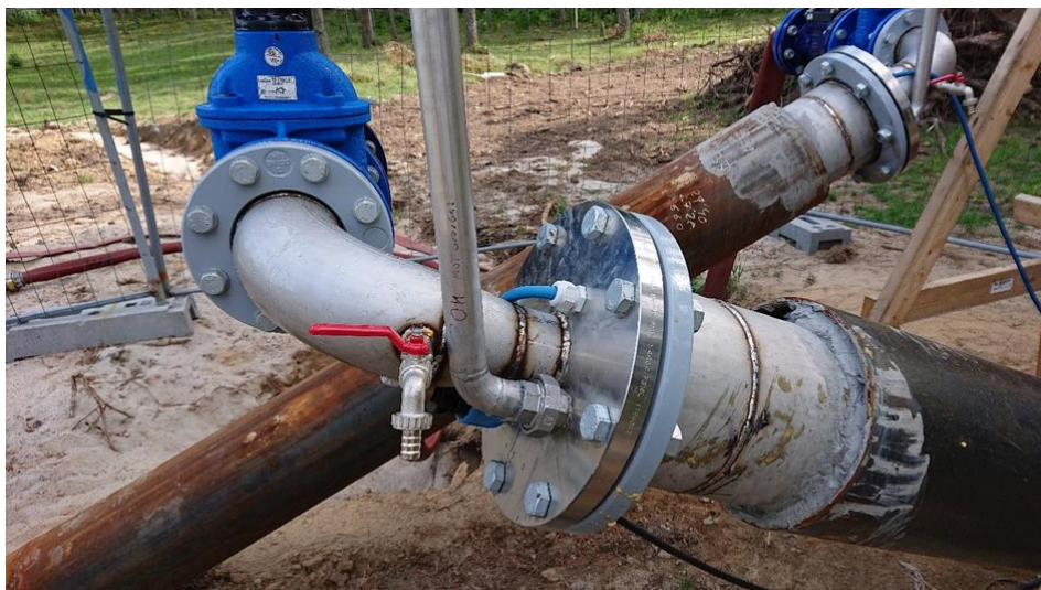
Figur 9. Brønnhodesikring i rustfritt stål med vanntette gjennomføringer (Skråbrønn-A og B, 27.6.2018).
