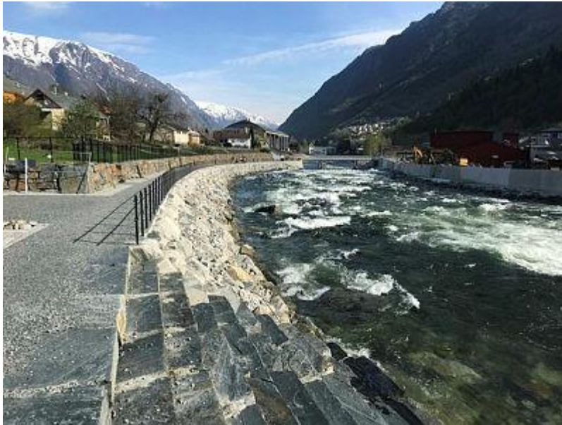
Bilde 6-1 Eksempel på flomsikring i Opo i Odda, Ullensvang kommune, med gangvei på «flomsletta» (Foto: NVE).
