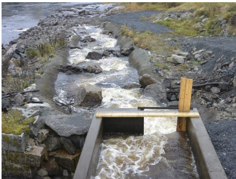
Figur 4 – Fisketrapp /slipp av minstevannføring Syvsætre foss kraftverk
