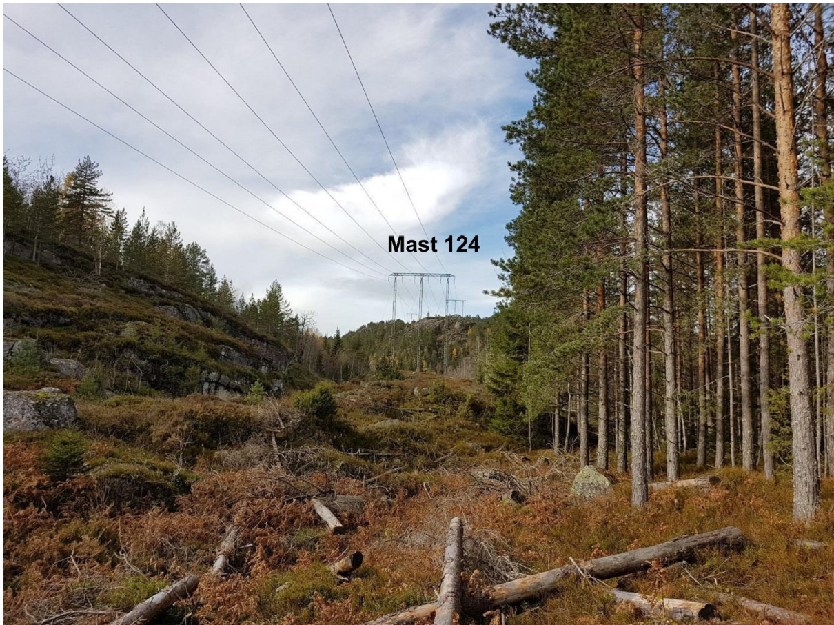
Figur 3-1 132 kV ledningene «Brokkeledningene». Bildet er tatt i retning norvest. Tørdal transformatorstasjon er planlagt i skogen til høyre i dette bildet.
