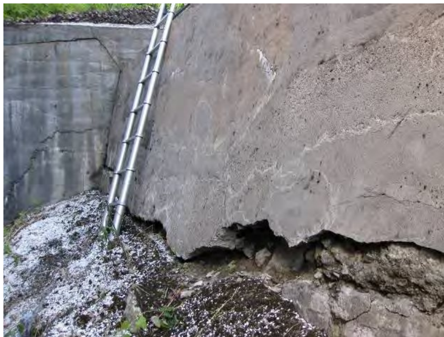
Bilde 5 - Forvitring i damfot ved massiv betongdam
