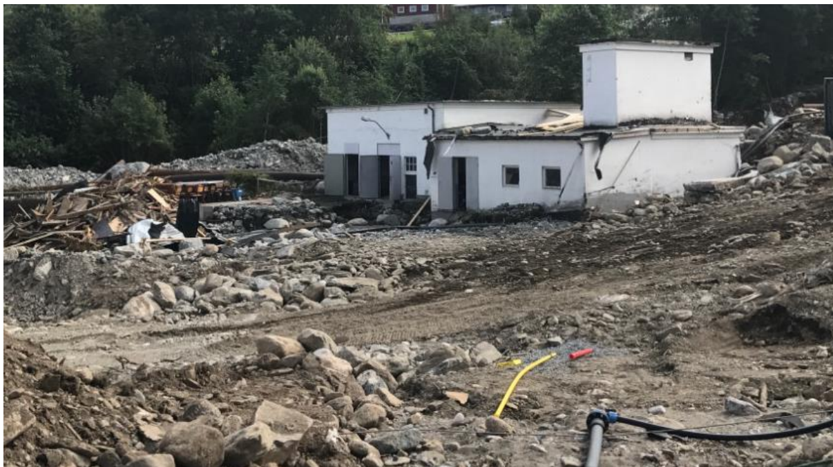
‘Gamlestasjonen’ med alt utstyr vart totalskada under flaumen som gikk over taket på heile bygninga!
