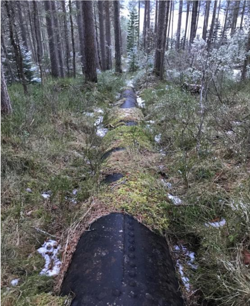
Den gamle rørgata i skogteigen nedanfor dammen. Det nye røyret vil ligge i same traseen etter at gamlerøyret er fjerna.
