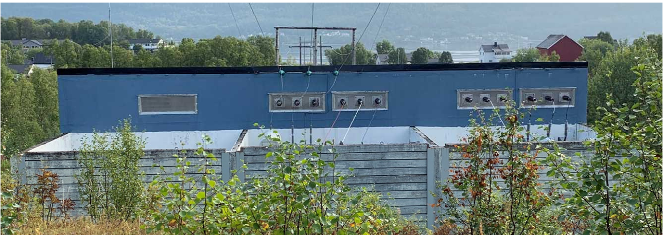
Figur 4-8 Silsand transformatorstasjon. Stasjonen vil utvides til venstre i bildet, og omsøkt ledning kables inn.
