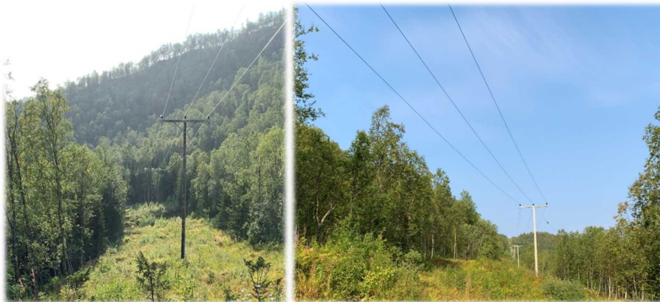
Figur 2-17 Eksisterende 22kV linje langs Lysvatnet. Stedvis meget sidebratt terreng kan gi utfordringer, jf. bildet til venstre.
