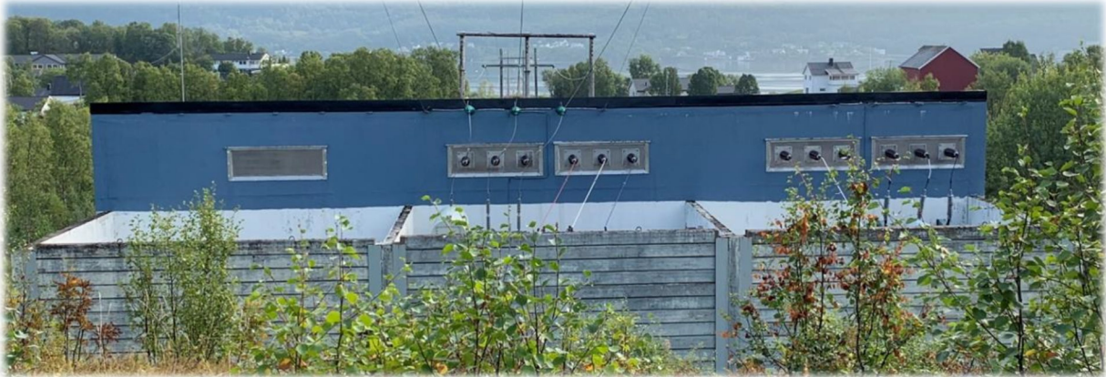
Figur 2-8 Silsand transformatorstasjon. Stasjonen vil utvides mot venstre i bildet, og ny ledning vil komme inn som jordkabel.
