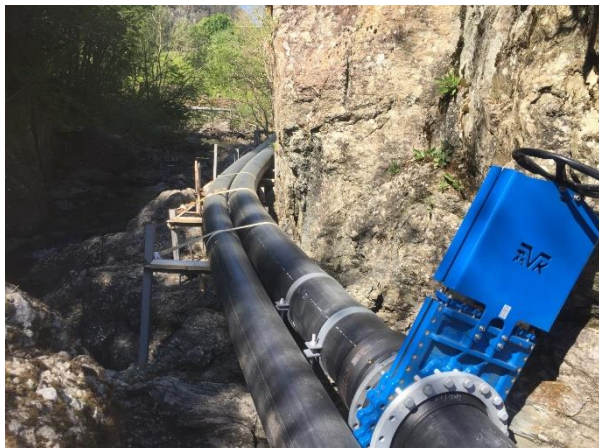
Bilde 1. Rørtrasè, 24.05.2018. Til venstre: rør fra inntak i Botsvatnet. Til høyre: rør fra inntak 2 med stengeventil.
