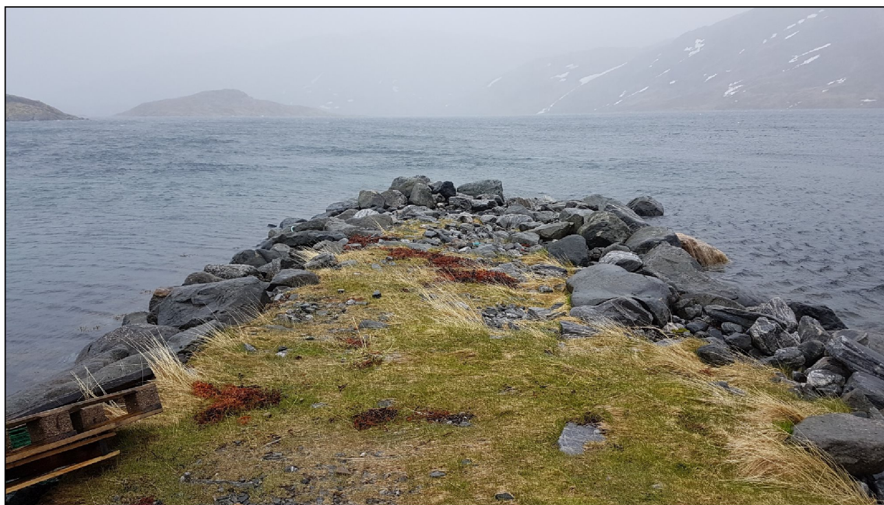
Figur 8. Eksisterende molo ved Elvestrand i Dønnesfjord. Moloen må utvides til ca. 6 m og forlenges med noe for kunne føre i land turbiner, transformatorstasjon og anleggsmaskiner. Utførelsen vil bli i betong eller stein.
