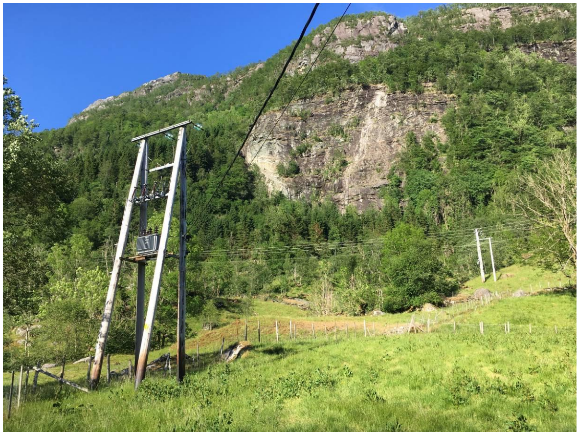
Bilde 5.1 22 kV linje og trafo
