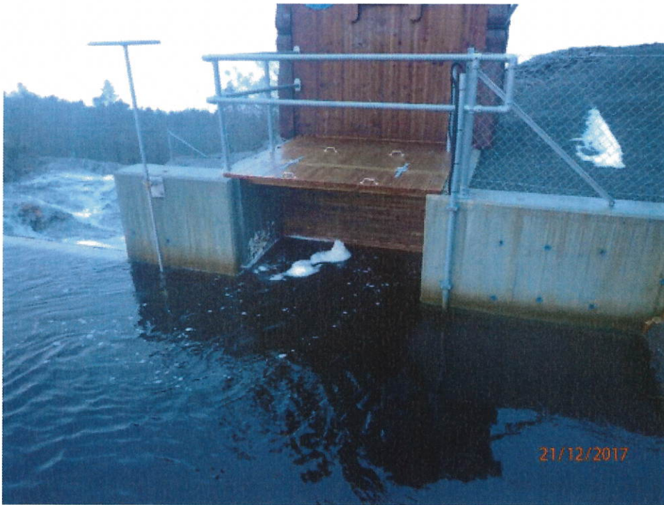
Bilde 5, tatt mot V, viser inntaket og flomløpet, som skal heves med 1,0 m
